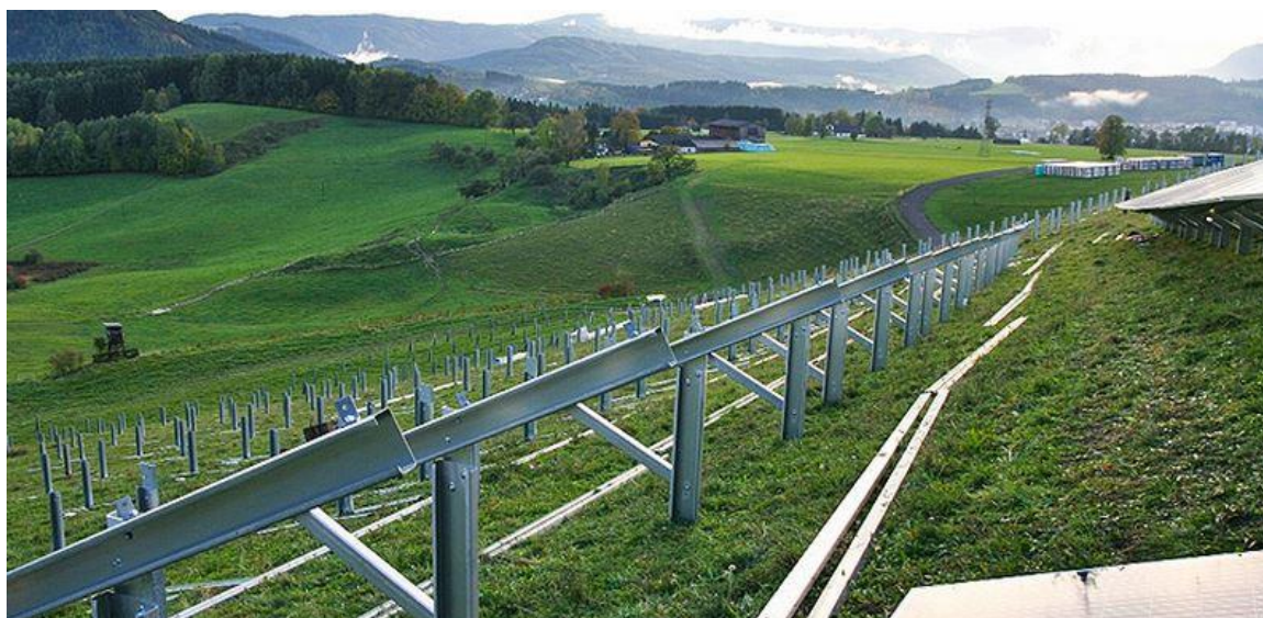
Zdjęcie 8. Konstrukcja przeznaczona do posadwienia paneli fotowoltaicznych.
