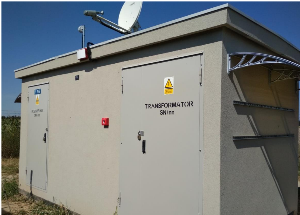
Fot. 3. Przykładowa stacja transformatorowa z urządzeniami sterującymi i monitorującymi, towarzysząca instalacji fotowoltaicznej w miejscowości Olszanka (woj. opolskie) [fot. Paweł Kręciproch]
