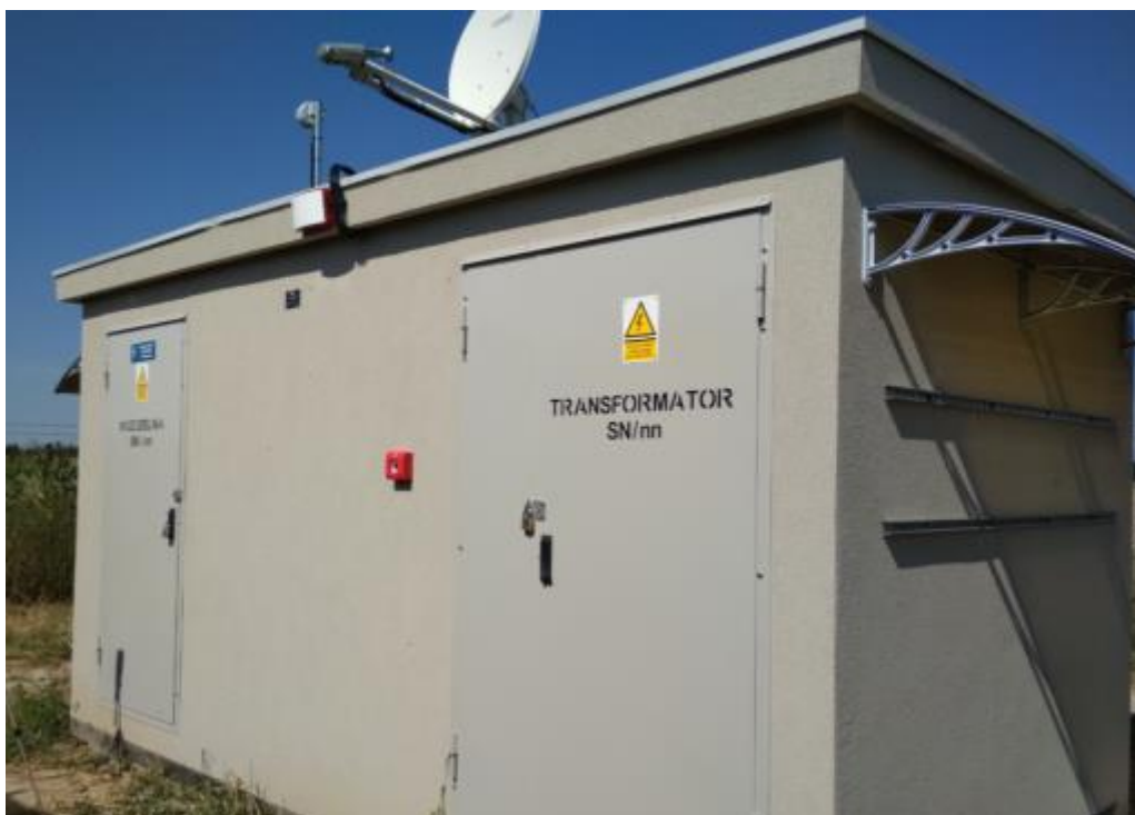
Fot. 3. Przykładowa stacja transformatorowa z urządzeniami sterującymi i monitorującymi, towarzysząca instalacji fotowoltaicznej w miejscowości Olszanka (woj. opolskie) [fot. Paweł Kręciproch]
