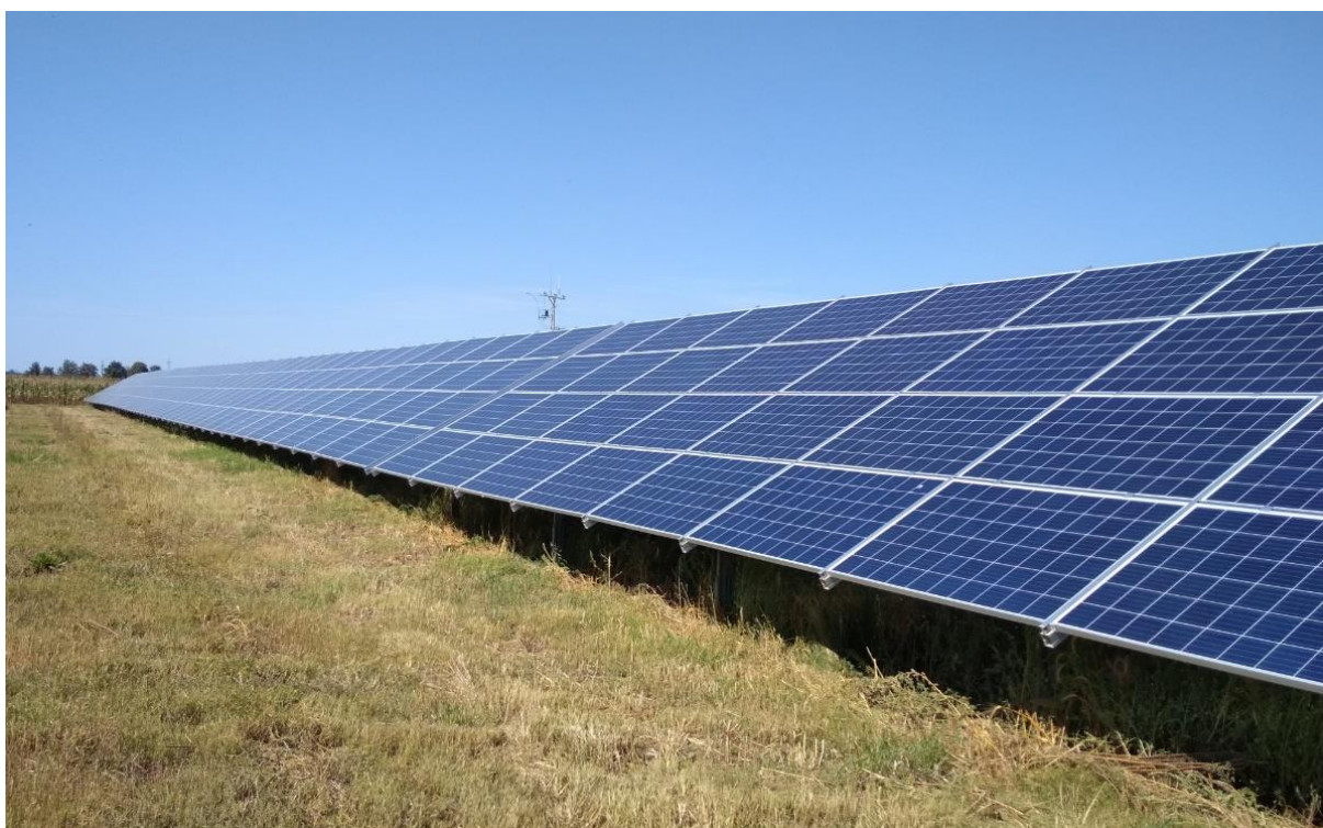
Fot. 2. Przykładowa naziemna instalacja fotowoltaiczna wraz z zagospodarowaniem powierzchni między rzędami paneli, miejscowość Olszanka (woj. opolskie), foto: Paweł Kręciproch
