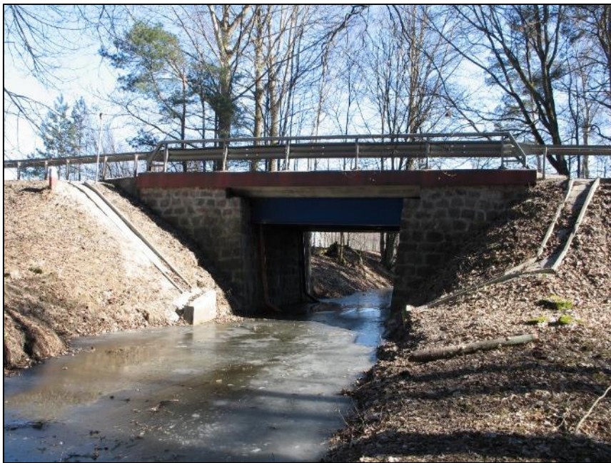
Fot. 14 Istniejący most w km 48+825 – brak półtek dla zwierząt.
