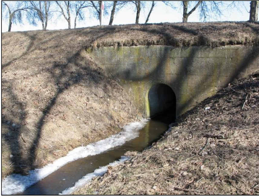
Fot. 13 Przepust w około km 45+122 – bariera w migracji zwierząt.
