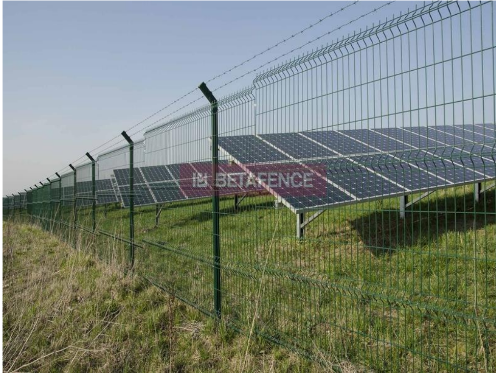
Rysunek 3: Przykładowe ogrodzenie farmy fotowoltaicznej
