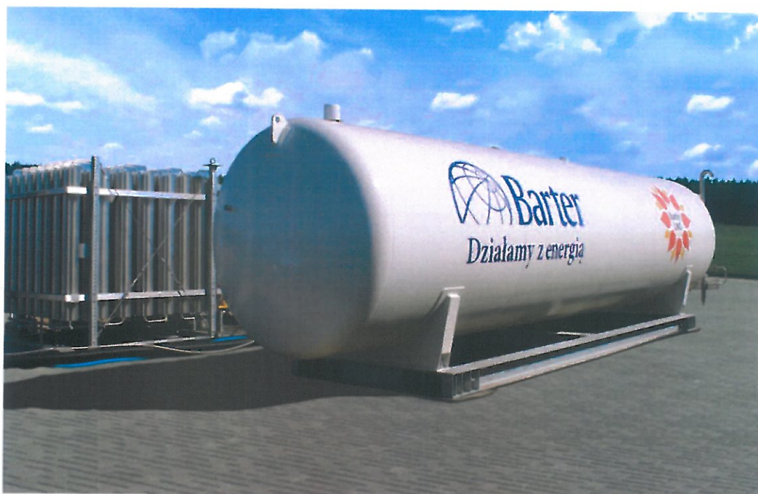
Rys. Mobilna stacja regazyfikacji skroplonego gazu ziemnego /LNG/
